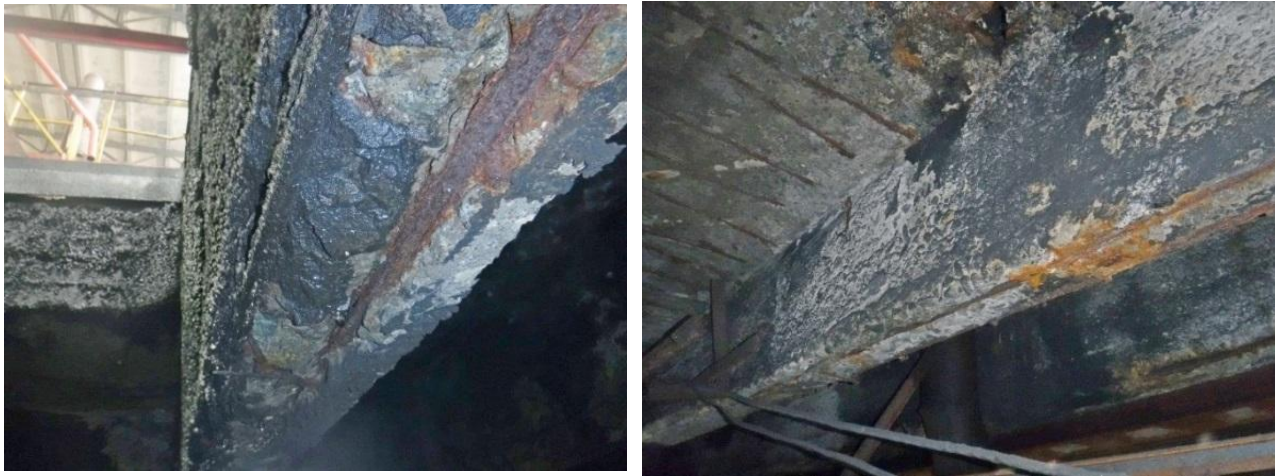
Рисунок 1 – Коррозионно-повреждённые железобетонные конструкции
